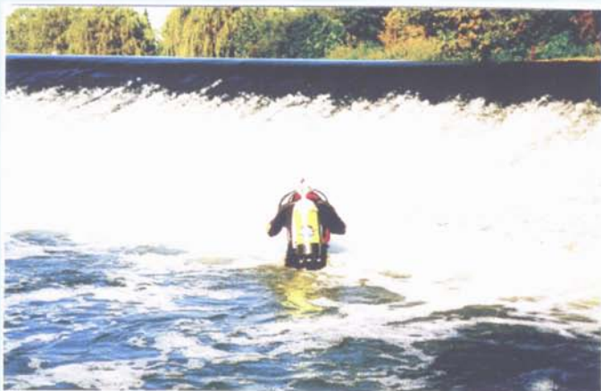
Beginn der Schadensuntersuchung des Wehres im Oktober 2000
